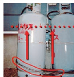
Một ví dụ về chốt an toàn bị lỏng.
